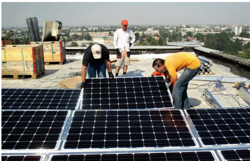
Berliner Kompetenz: Die neue Photovoltaikanlage auf dem Universitätsdach in Taschkent
